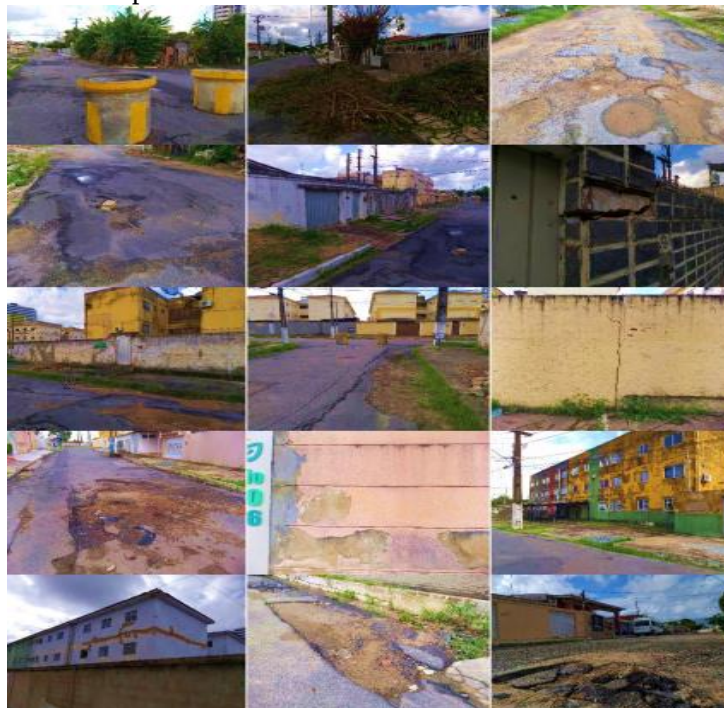
Figura 11 - Impactos estruturais no bairro do Pinheiro em Maceió/AL.
