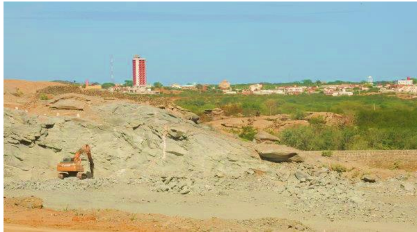
Figura 4 – Mineração no entorno de centro urbano que geram impactos visuais, resultantes dos altos volumes de rocha e solos movimentados.
