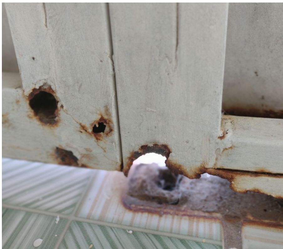
Figura 6 - Corrosão em uma superfície de ferro
